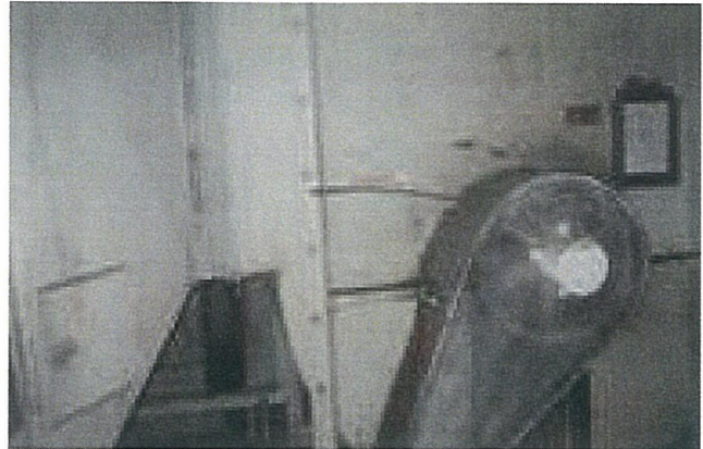
Wilber Hall - Exhaust Fan
